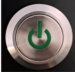
Fig. 13: Interrupteur de batterie principale éteint
